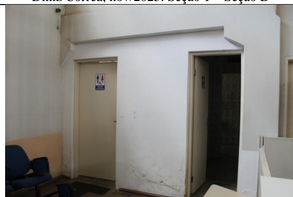
Imagem 06: Banheiros. Fotografia de Jaíne Diniz Corrêa, nov/2025. Seção 1 – Seção B
